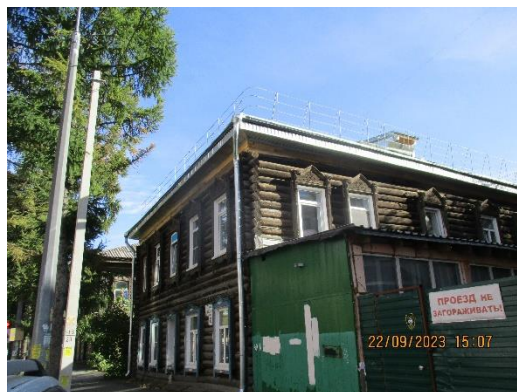
Капитальный ремонт крыши выполнен в доме по адресу: г. Томск, ул. Никитина, д. 35
