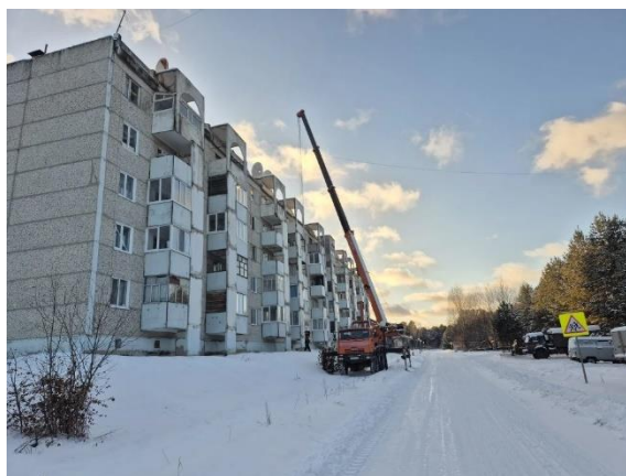
В 5-ти этажном доме № 40 в г. Кедровом в 2025 году приступили к переустройству малоуклонной крыши в скатную, благодаря поддержке в организации работ со стороны Администрации г. Кедрового и слаженной работе подрядной организации. Стоимость работ составляет около 80 млн.рублей
