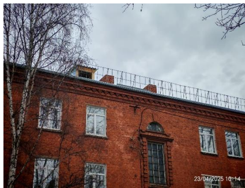
Капитальный ремонт крыши завершен в многоквартирном доме по адресу: г. Томск, ул. Пушкина, д. 52
